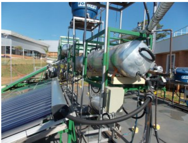
Figura A8: Detalhe da lateral da entrada de água fria do coletor de tubos à vácuo.
