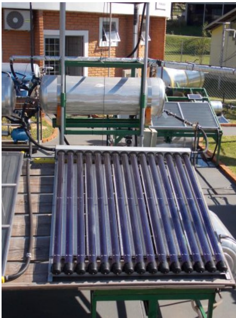
Figura A2: Detalhe do sistema com coletores de tubos à vácuo.
