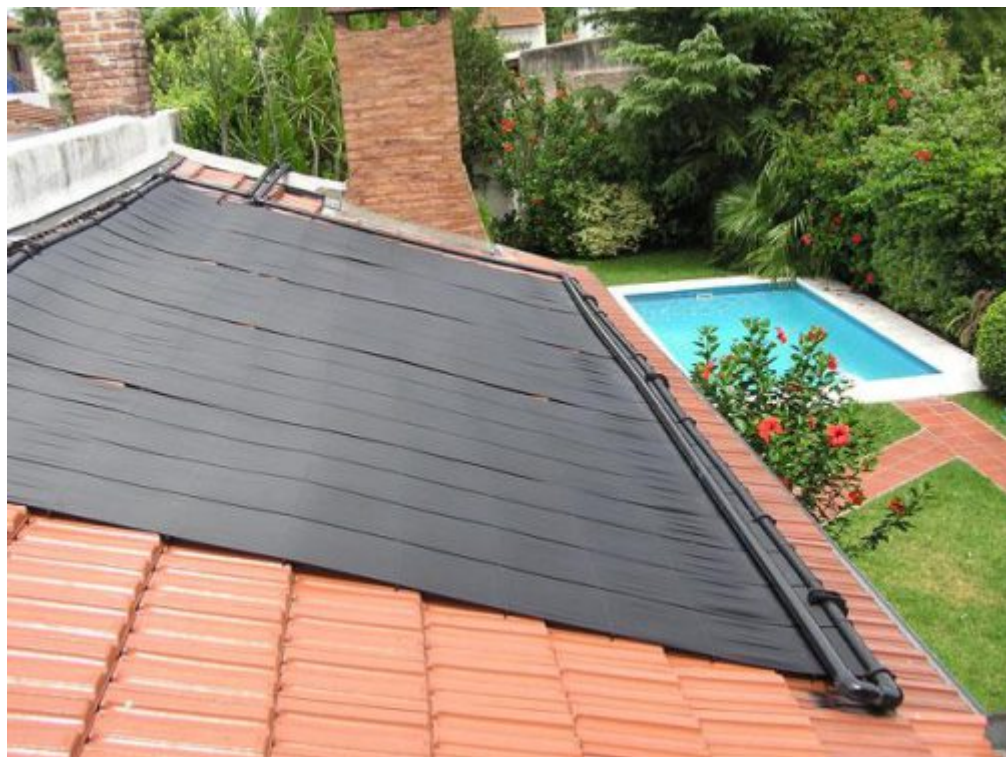
Figura 2: Instalação de coletores planos abertos para aquecimento de piscina. Fonte: Suacci.
