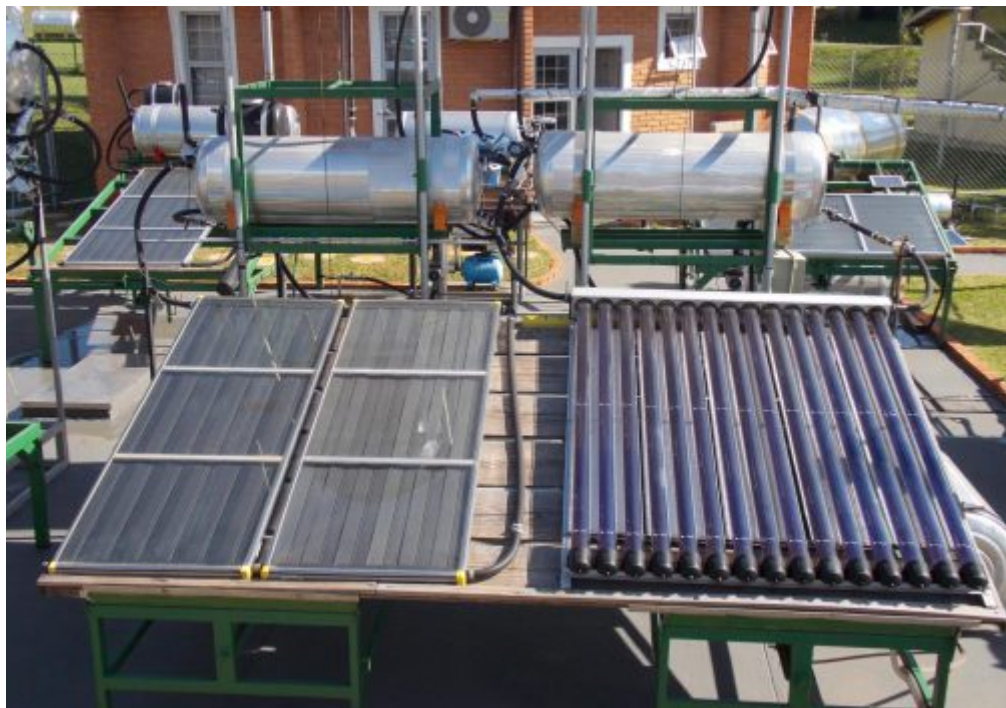
Figura 13: Sistemas de aquecimento solar utilizados nos experimentos.
